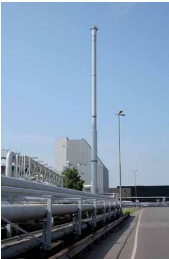
Mer enn to tredjedeler av Borregaards energiforbruk er varmeenergi i form av damp og varmtvann. Biokjelen som ble åpnet i 2005 produserer varme basert på restprodukter fra produksjonen.
